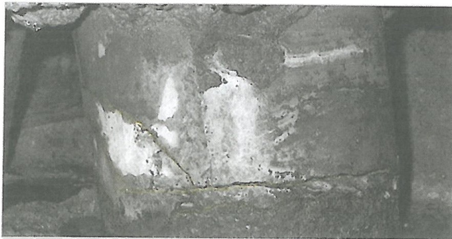
Fendilhação das estacas do viaduto (em cima) e do cais Sul (em baixo)
