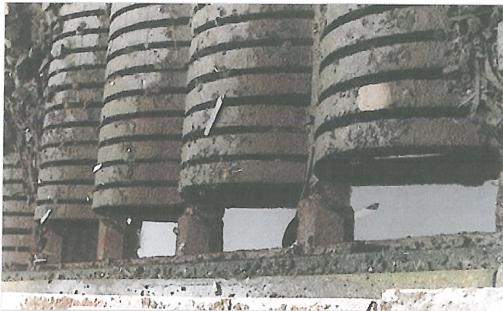
Fendilhação das estruturas
