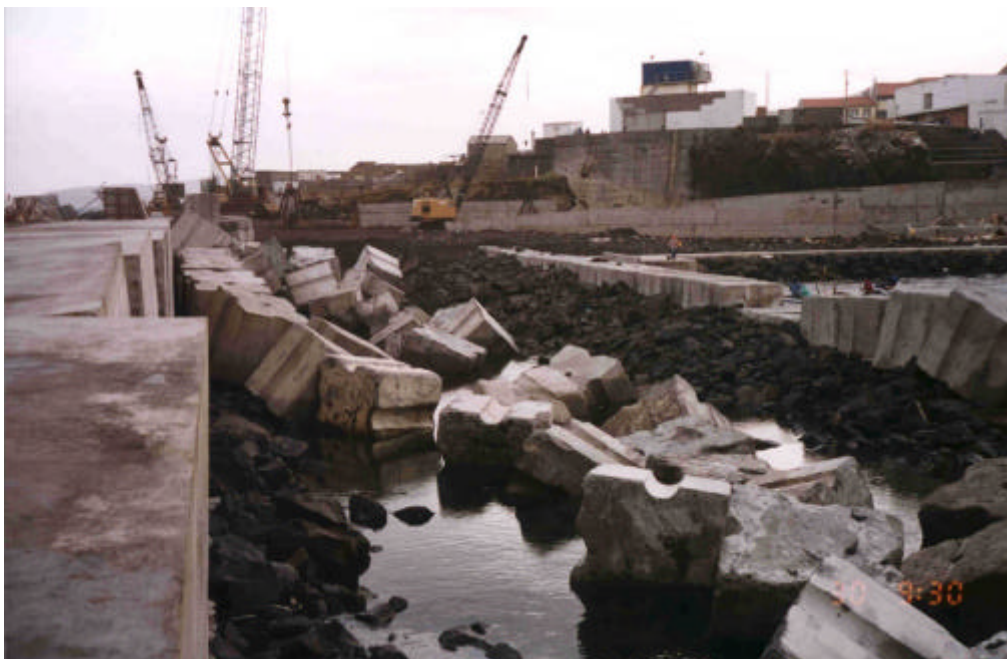
Figura 5 – Porto de Rabo de Peixe. Situação da obra após do temporal de 22 de Outubro de 1999. Blocos projectados para o terrapleno e assentamento do muro cortina.
