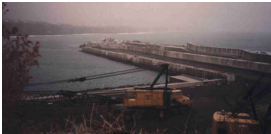
b) Vista geral do quebramar antes do temporal.
