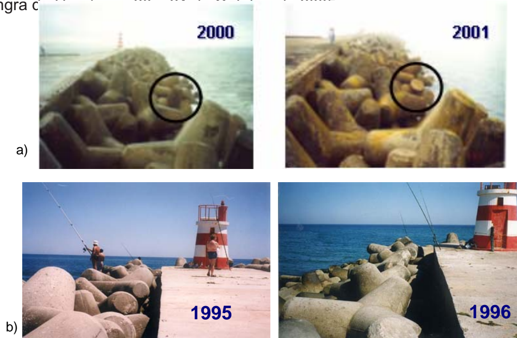
Fig. 5 - Evolução sofrida pelos elementos de um quebra-mar: a) Movimentos sofridos pelos blocos constituintes do manto resistente b) Assentamentos sofridos pelo manto resistente
