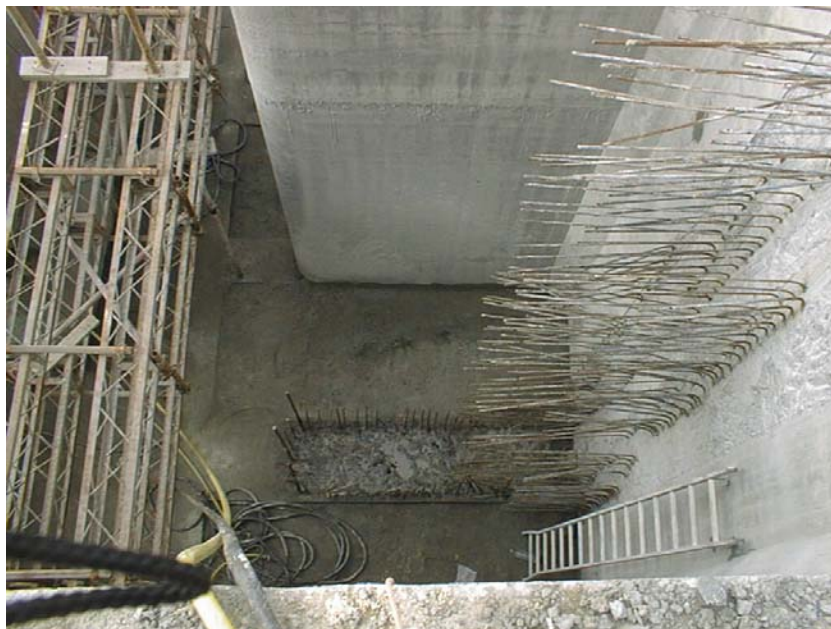
Fig. 15 – Destacamento de armaduras de espera para realização dos elementos estruturais na 2 a fase.
