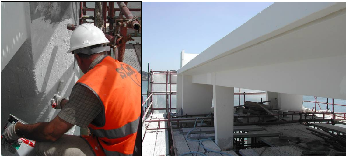
Fig. 7 – Pintura dos pilares (esq.) e aspecto da cobertura após a pintura (dir)
