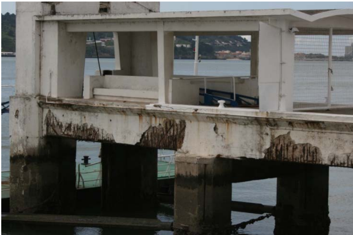
Fig. 1 – Aspecto geral das patologias do cais da Princesa
