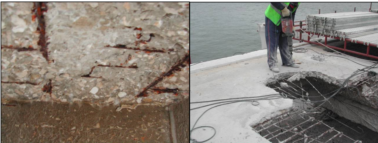
Fig. 3 – Detalhe do avançado estado de corrosão encontrado nas armaduras das vigas (Esq.) e demolição integral das lajes (dir.).
