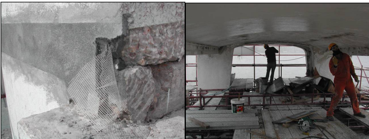
Fig. 5 – Reparação de fissuras com fibra de vidro (esq) e pintura do tecto (dir.)
