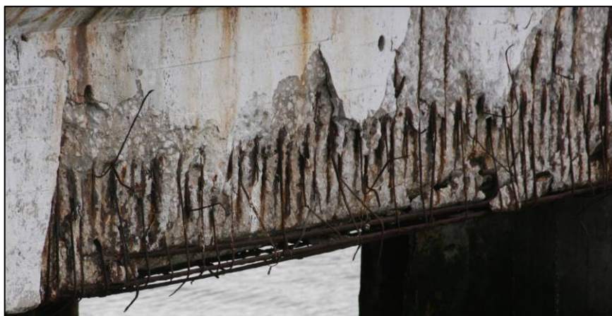
Fig. 2 – Detalhe do avançado estado de corrosão das armaduras
