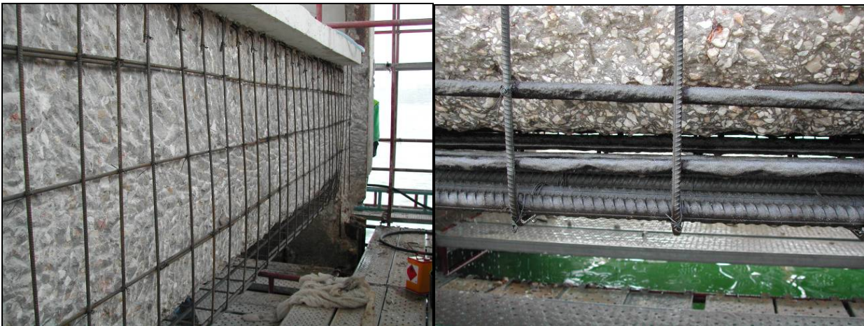
Fig. 4 – Viga preparada para ser betonada (Esq.) e detalhe dos varões de aço após a limpeza e substituição (dir.)
