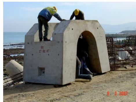
Fotografia 6 – Estabilizador. Emissário Tanger ( V = 5,16 \text{ m}^3 )
