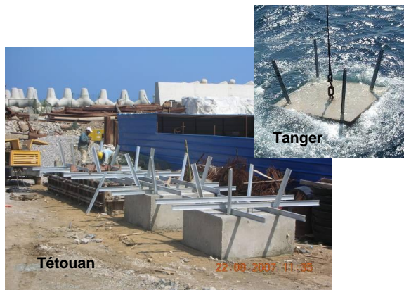
Fotografia 21 – Blocos de protecção dos difusores
