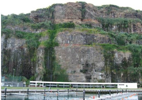
a – Vista da escarpa antes da realização dos trabalhos de consolidação
