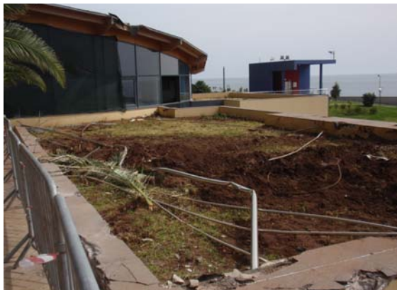
b – Danos resultantes do desprendimento de alguns blocos
