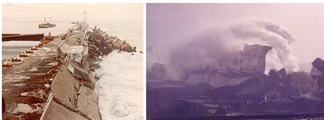
Figura 4: Colapso do manto de protecção e da superestrutura do molhe Oeste do Porto de Sines
