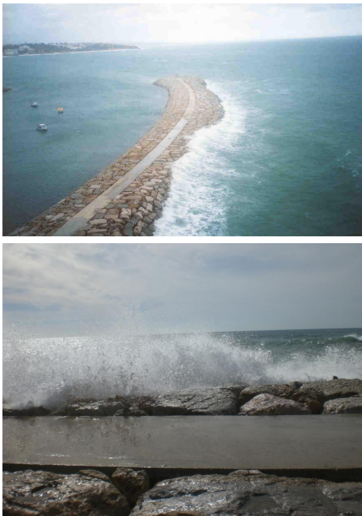
Figura 5. Espriamento / galgamento no quebra-mar Poente (4-7 de Dezembro de 2006 e 26 de Outubro de 2009).
