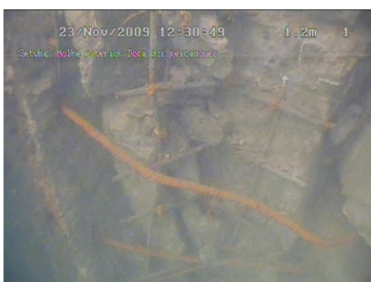
Figura 19 – Rotura da parede exterior. Vista do nó de ligação com a parede transversal interior do lado de jusante.
