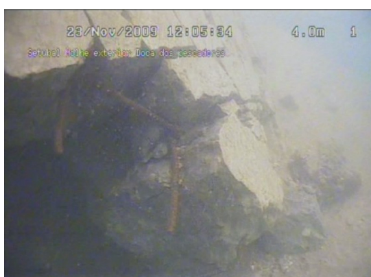
Figura 20 – Rotura da parede exterior. Vista da parte inferior do painel de parede destruído, depositado sobre o prisma de material de enchimento acumulado no fundo da célula.
