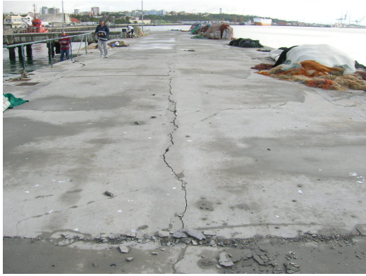
Figura 11 – Fendilhação da superestrutura.
