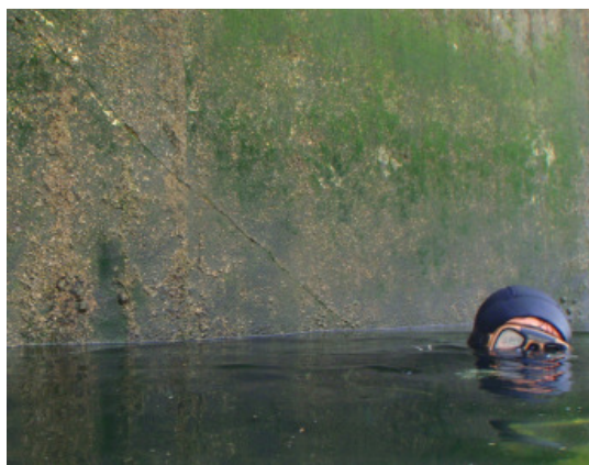
Figura 18 – Fissuração da parede exterior.
