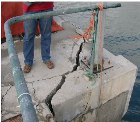
Figura 13 – Rotura no intradorso.
