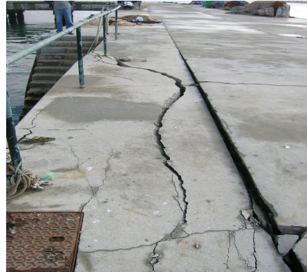
Figura 12 – Fendilhação da superestrutura junto à escada.
