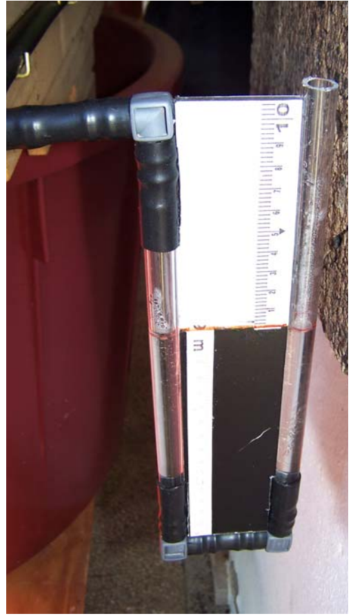
Piezómetro de verificação das pressões de ar instaladas no interior dos reservatórios.
