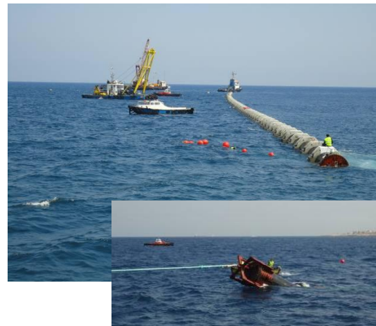
Fotografia 2 – Afundamento do tubo
