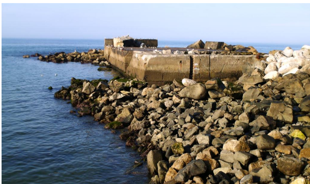
Figura 6 – Zona em ruínas (cais em primeiro plano) do molhe-cais da Ericeira (Agosto, 2008)
