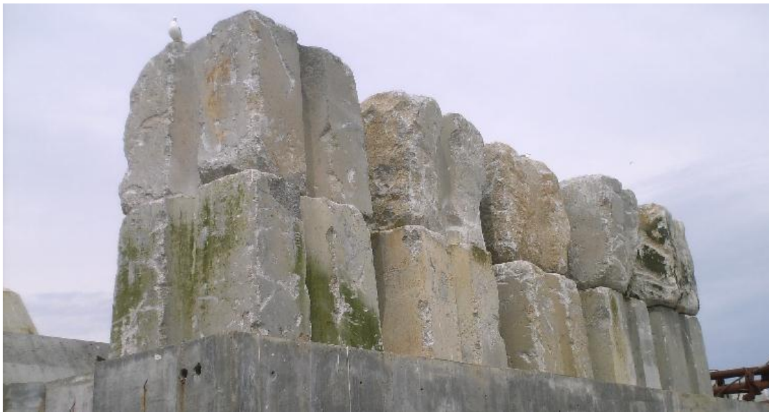
Figura 18 – Blocos Antifer de 400 kN danificados
