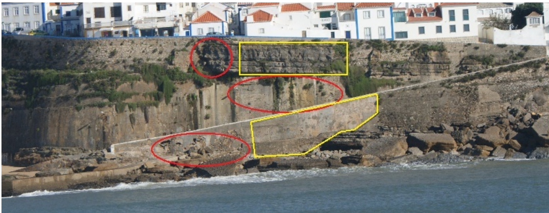
Figura 8 – Infografia da vista da arriba na rampa Sul em Novembro de 2010. Assinalado a amarelo as zonas da arriba que se mantiveram estáveis comparando com 2005. Assinalado a vermelho as zonas da arriba que se agravaram comparando com anterior vistoria efectuada em 2005.
