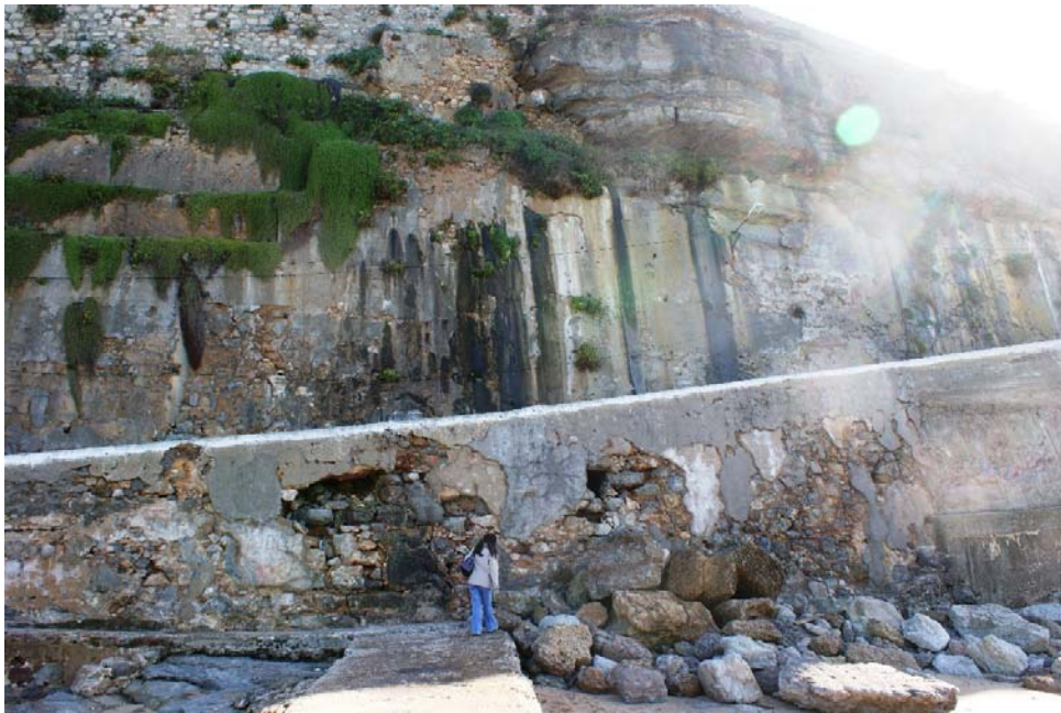
Figura 7 – Infografia da vista geral da arriba e da rampa, onde se verificam potenciais processos de instabilidade, nomeadamente queda de blocos, desprendimento de elementos e abatimento do pavimento da rampa.
