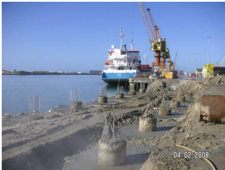
Figura 8 – Aspecto da execução das estacas das fiadas A, interior, e B, intermédia.
