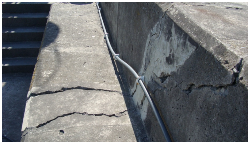
Figura 1 – Fendas identificadas na superestrutura do quebramar do porto do Funchal.
