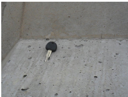
Figura 6. Bolhas na superfície do betão, formadas na interface plana cofragem-betão de um Accropode TM .
