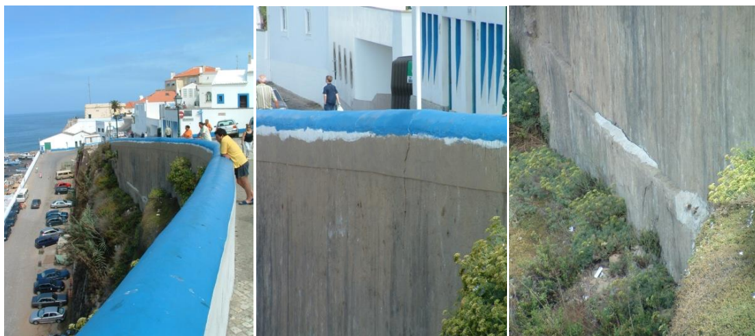
Figura 17 – Aspecto do muro adjacente à Capela de Sto António, antes da intervenção. Note-se as fendas verticais nos limites do troço instabilizado, e respectivo deslocamento dos bordos.
