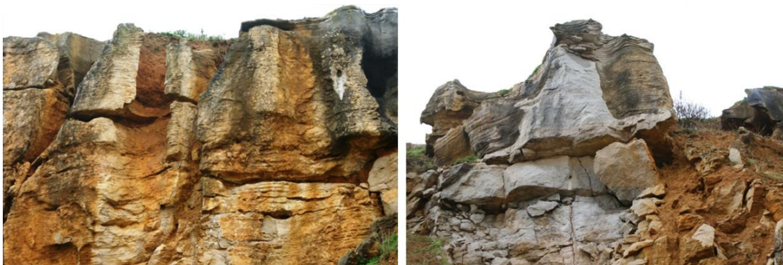
Figura 14 – Infografia exemplificativa da situação existente: camadas calcárias meteorizadas e material de alteração dos calcários, camadas calcárias em consola, blocos sem sustentação, falhas, discontinuidades e fracturas, vestígios dos furos para desmonte a fogo, etc. – fotografias de 06-12-2010.
