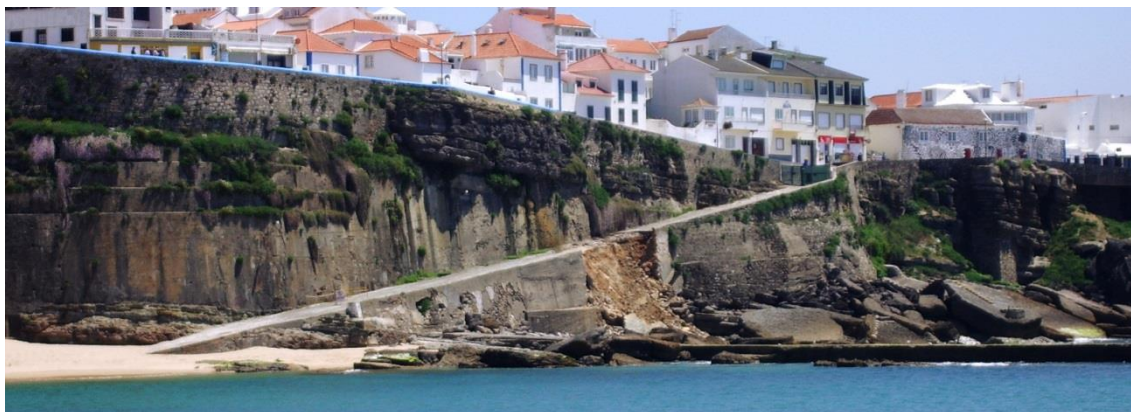
Figura 24 – Aspecto de muro de suporte da rampa após a rotura do troço central, em Maio de 2012.
