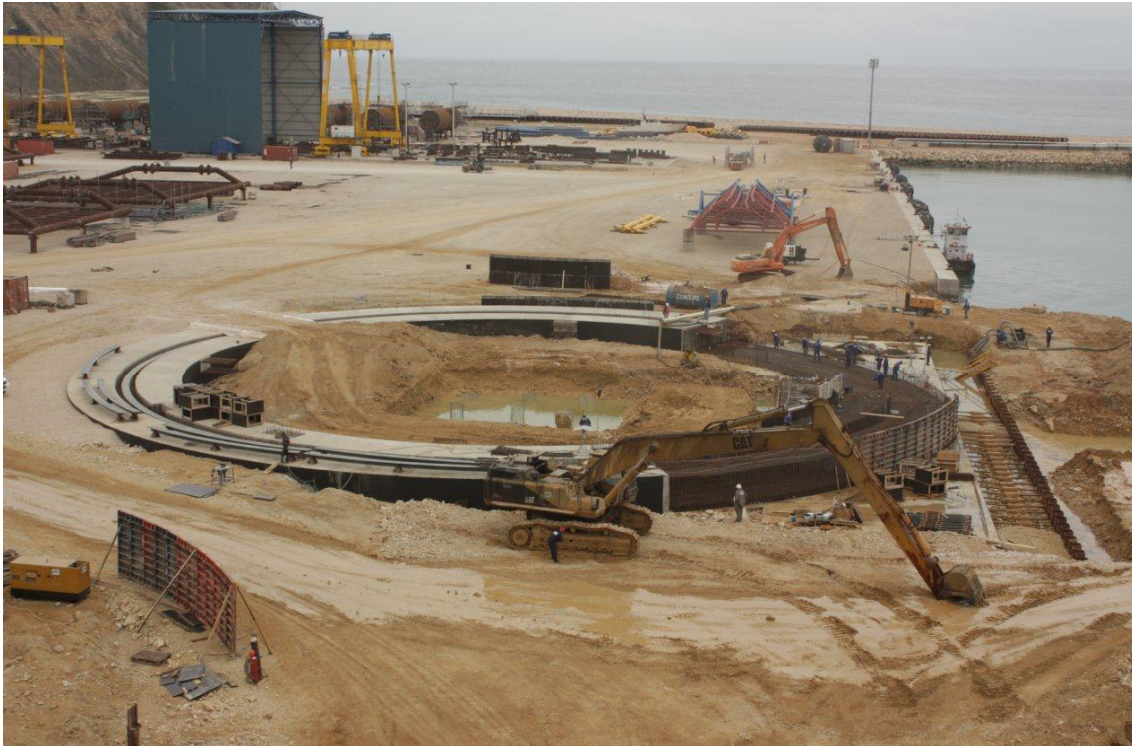
Figura 11 – Fecho do maciço de fundação do caminho de rolamento da grua, no troço sobre a plataforma de alívio.
