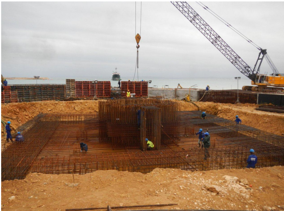
Figura 12 – Montagem das armaduras do maciço de fundação do apoio central da grua.
