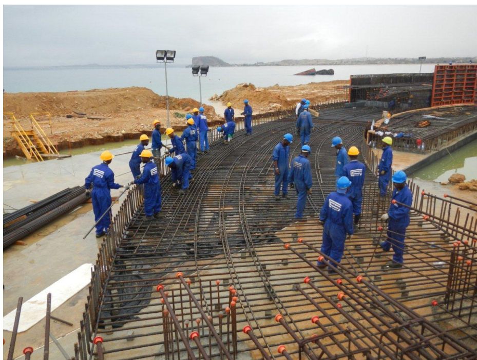
Figura 10 – Montagem da armadura do maciço de fundação do caminho de rolamento da grua.
