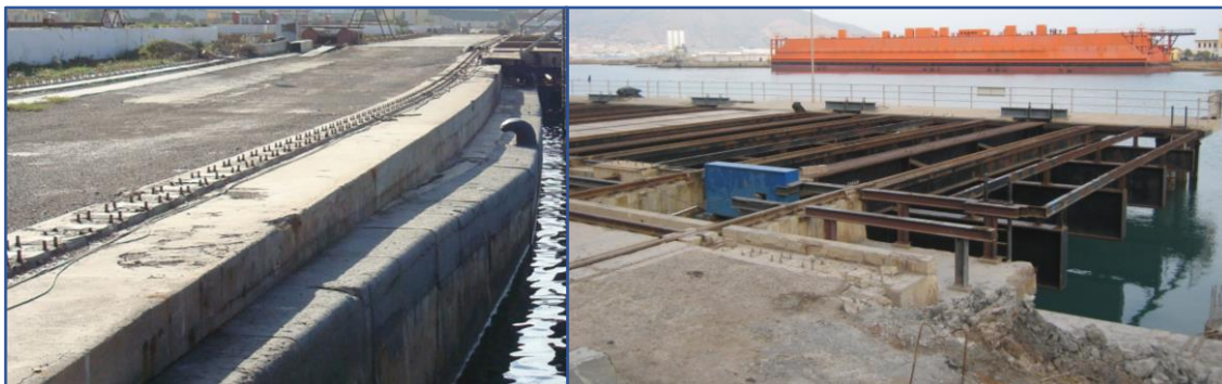
Figura 2 – Imagens de algumas patologias observadas nos muros cais e plataforma elevatória
