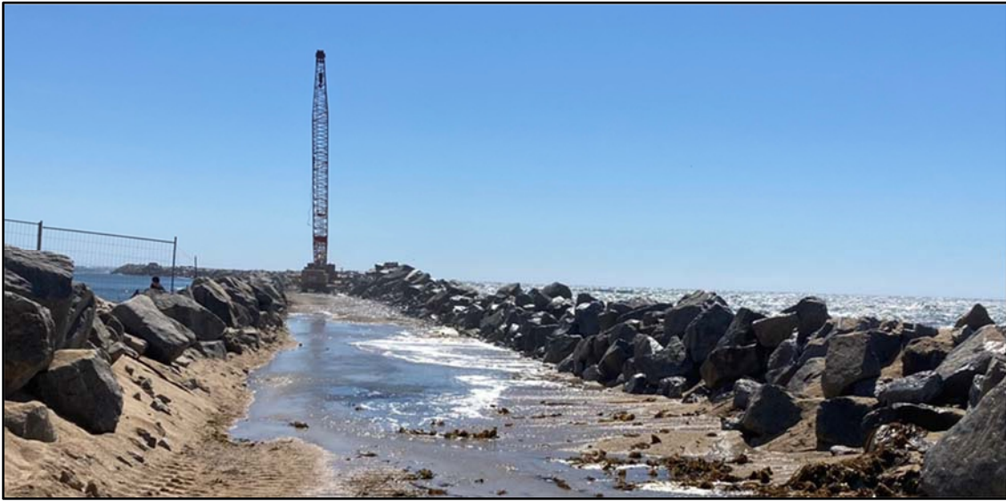
Figura 11. Galgamentos durante as betonagens da superestrutura
