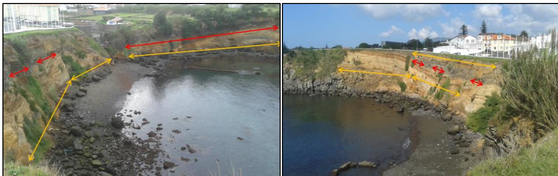
Figura 7. Identificação de zonas de risco.
