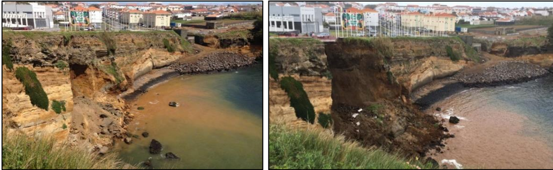
Figura 16. Fotos de duas fases do deslizamento de terras ocorrido no início dos trabalhos.
