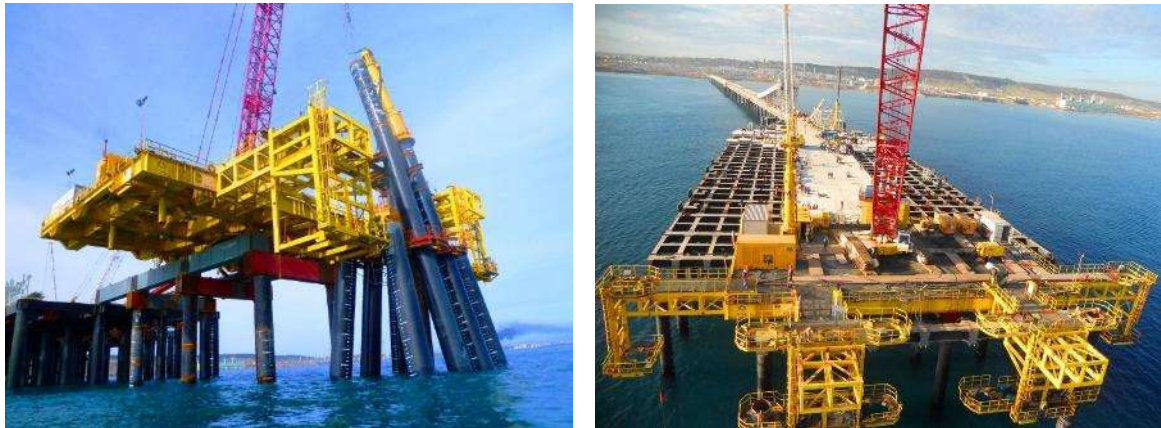
Figura 7 e 8: Cantitravel utilizado na construção do jetty do terminal de exportação de fertilizantes ARZEW – Argélia
