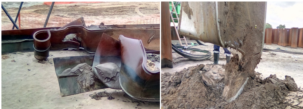
Figura 11 – Danos nas pontas das estacas em perfil HZ.
