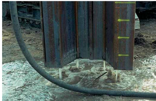
Figura 12 – Sistema de injeção de água utilizado.
