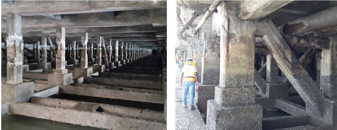
Figura 1. Condição das estruturas de cais existentes
