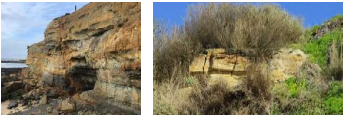
Figura 2 – Cavidade de grandes dimensões na arriba da Praia da Bafureira / Queda de blocos calcários junto à Praia das Avencas
