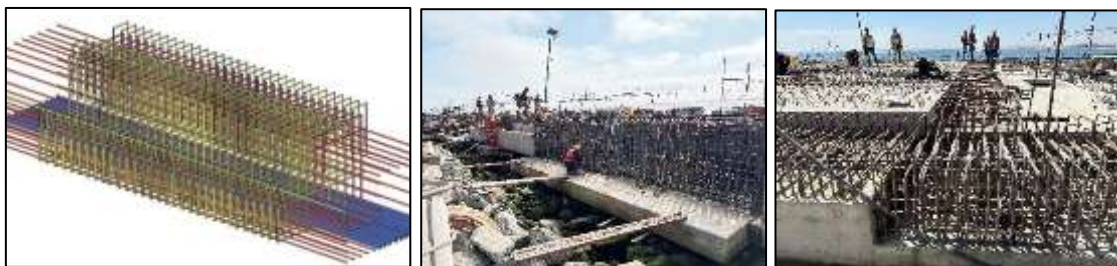
Figura 5. Nó de viga longitudinal lado terra com estaca, ilustrando a densidade de armadura.
