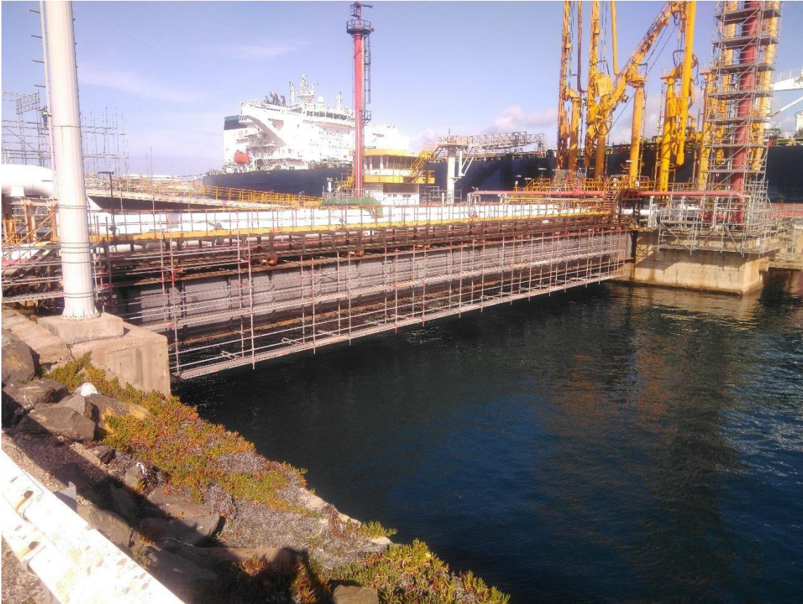
Figura 2. Estruturas portuárias expostas ao ambiente marítimo agressivo.
